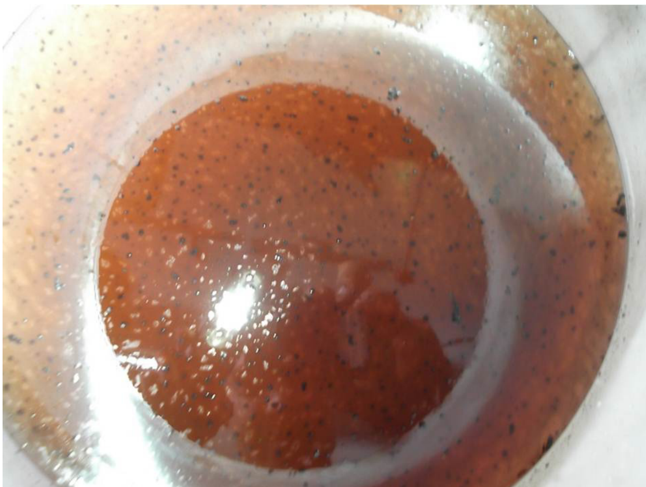
Bild 1 (Rückstände im Kühlmittelausgleichbehälter)
